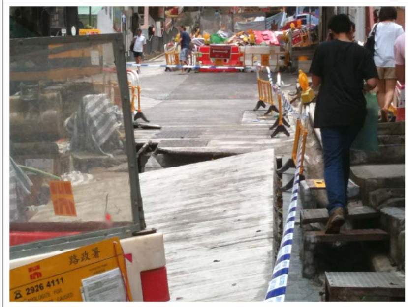
路陷封閉的正街道路
