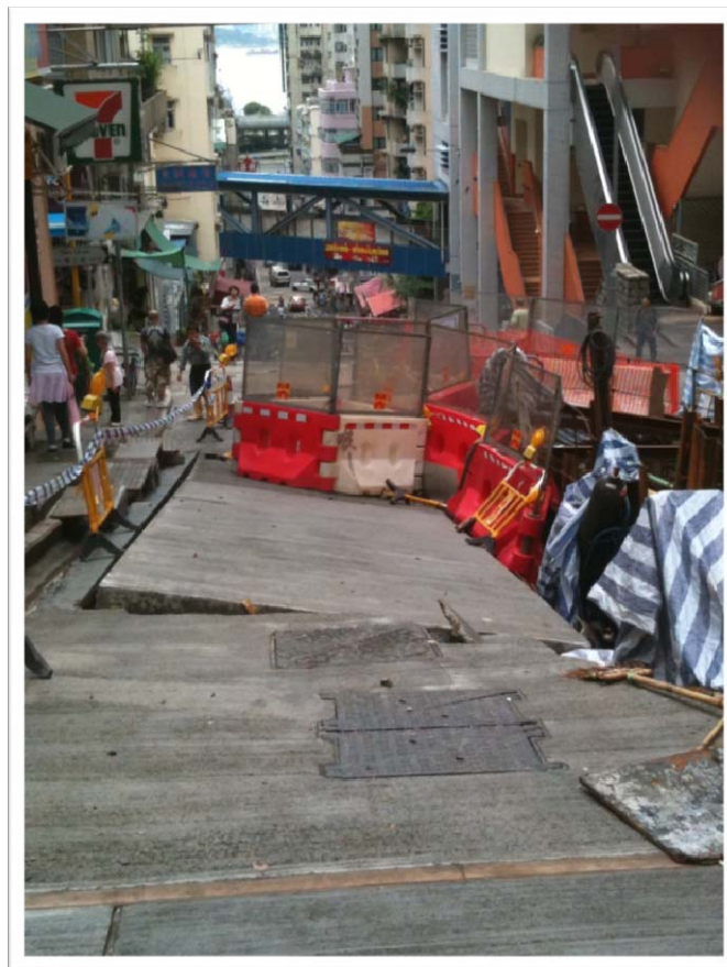
路陷封閉的正街道路
