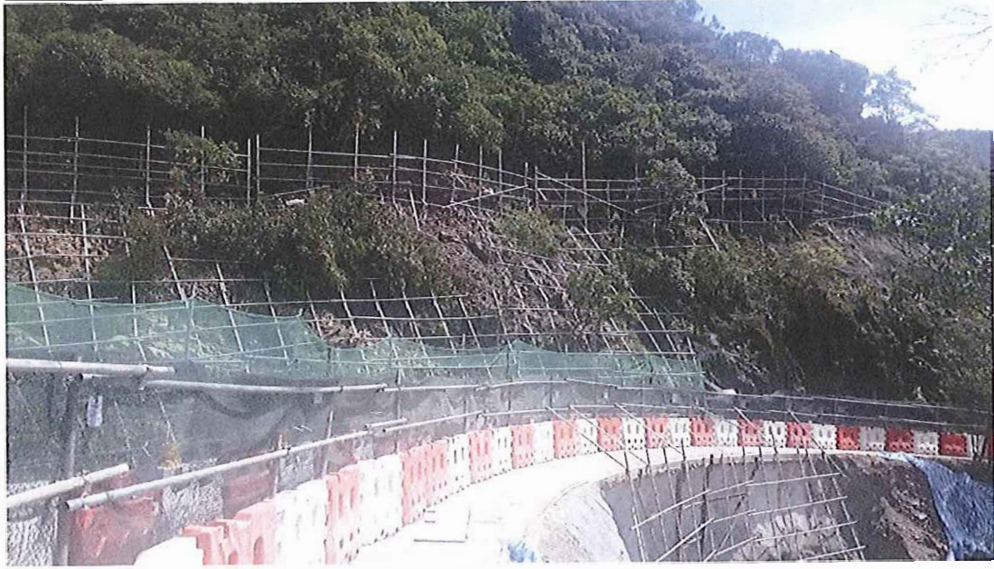
附圖三：西貢西灣路的山泥傾瀉情況（一）
