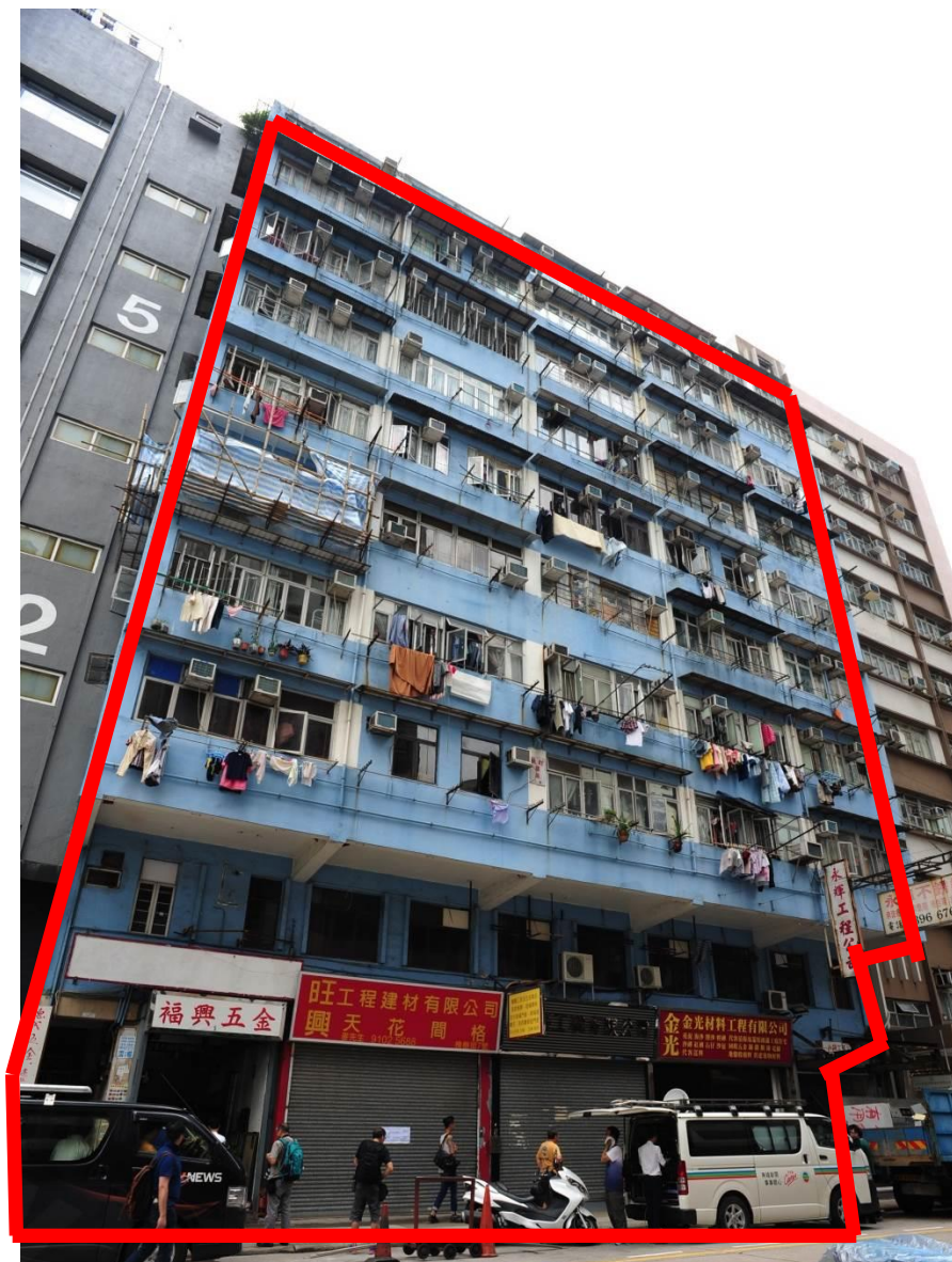
樓宇狀況屬失修，部份的公用地方及牆身出現滲水，裂縫，石屎爆裂及鋼筋外露，天台蓋搭有僭建物
