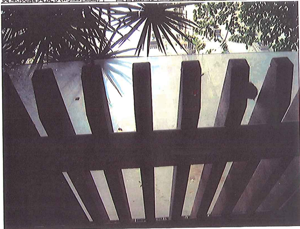
圖 1：西安里兒童遊樂場座椅蔭棚(可惜漏水，需維修)
