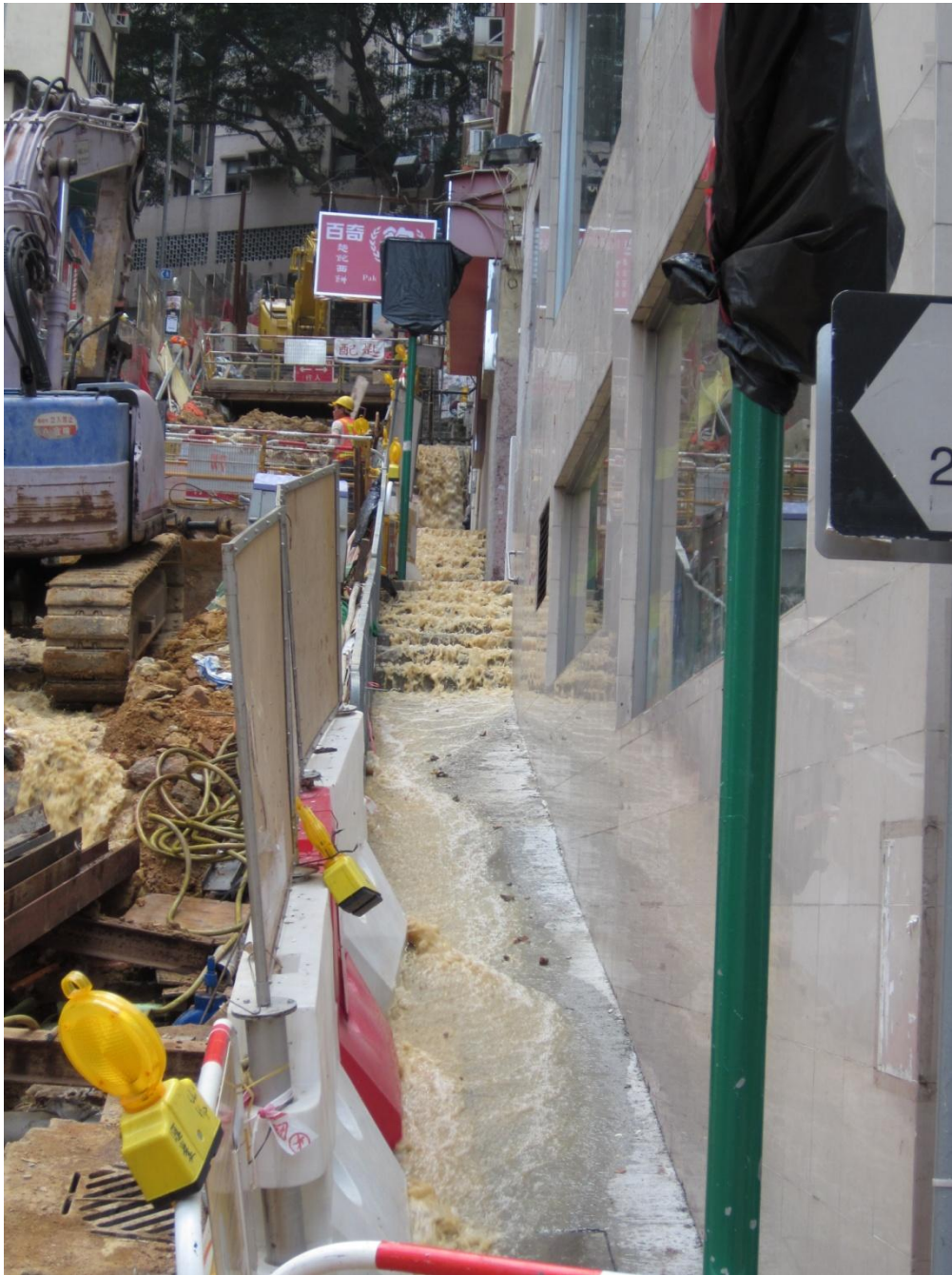
水管爆裂後的正街
