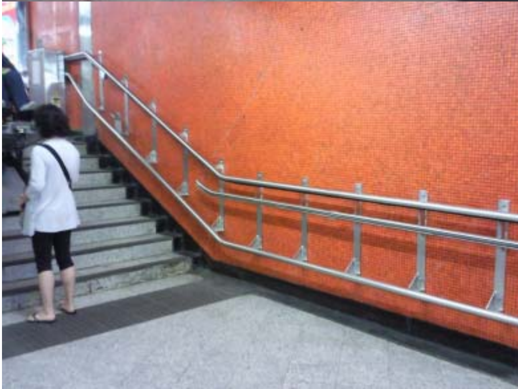
現時位於天后港鐵站之梯級升降機，經常故障停用，而且需要車站人員輔助，故並未能完全輔助到有需要人士。
