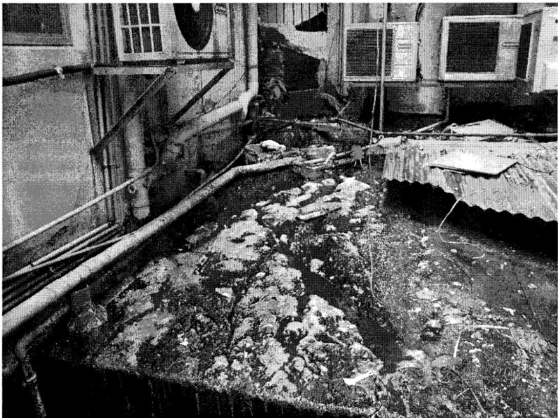
圖二：漏出的糞便，則沿著馬頭圍道 2 號單位的屋頂積存往該廈的雨水渠。
