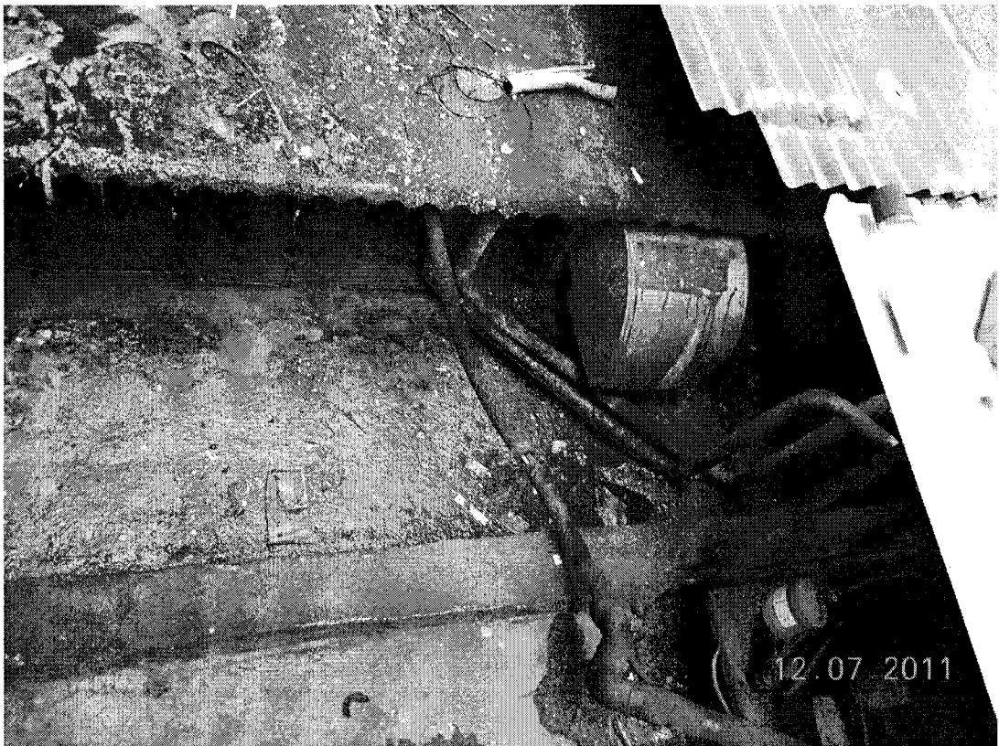
圖四：要求基於公眾環境衛生，馬上維修糞渠杜絕滲漏問題
