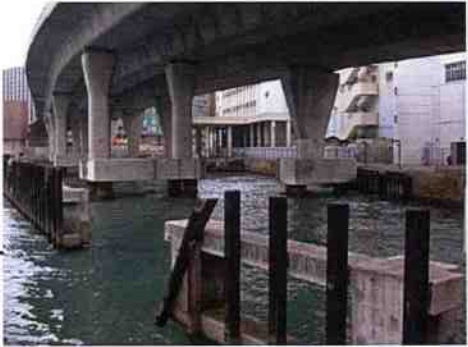
紅磡繞道防撞欄樁柱
