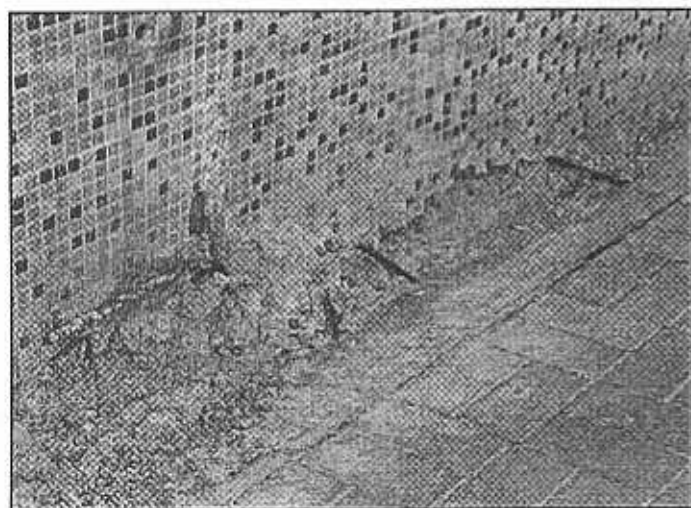
(圖三) 露出鋼筋及其破爛缺口參差鋒銳
