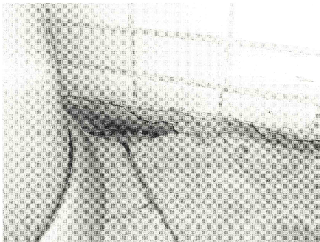
位於九龍南線地盤旁的奧海城第2期出現了沉降的現象，大廈外牆牆腳也多處裂成長長的缺口。
