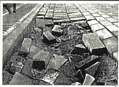
■其中一處靠近港鐵九龍南線工程地盤的位置，沉降令原來的地磚下陷。
