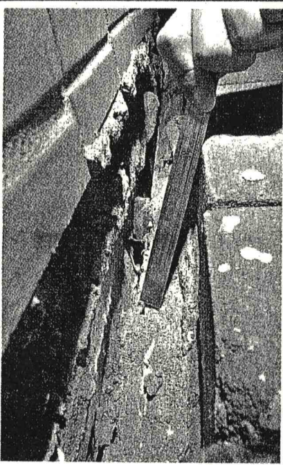
■商場牆身一處沉降位置，露出10厘米深裂痕，可看到地下沙泥。
