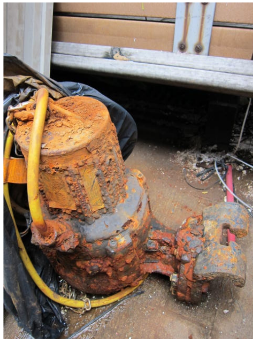
已損壞的循環水泵
