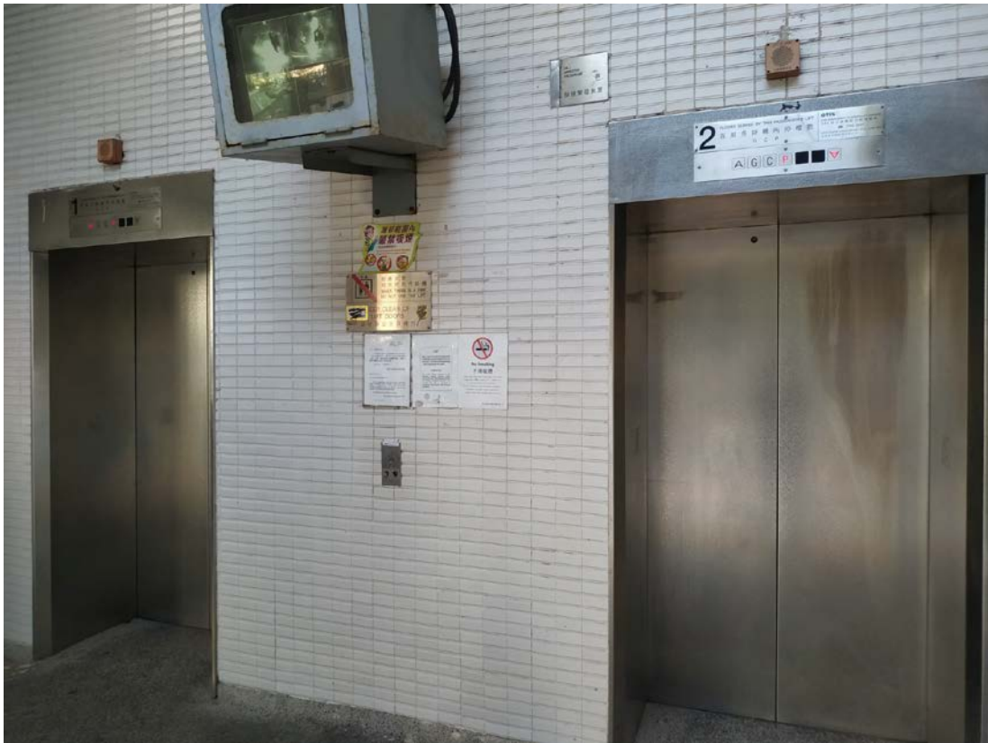
現有東熹苑耀熹閣出口的升降機
