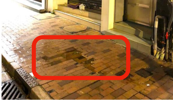
圖一 東大街路面凹凸不平情況
