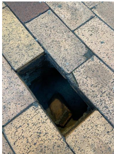
圖四 東大街地陷內部情況
