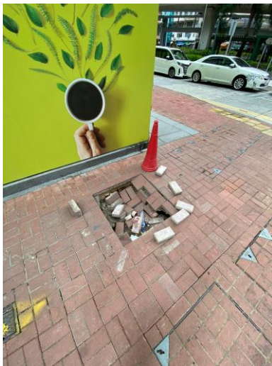
圖三 工廠街路面地陷
