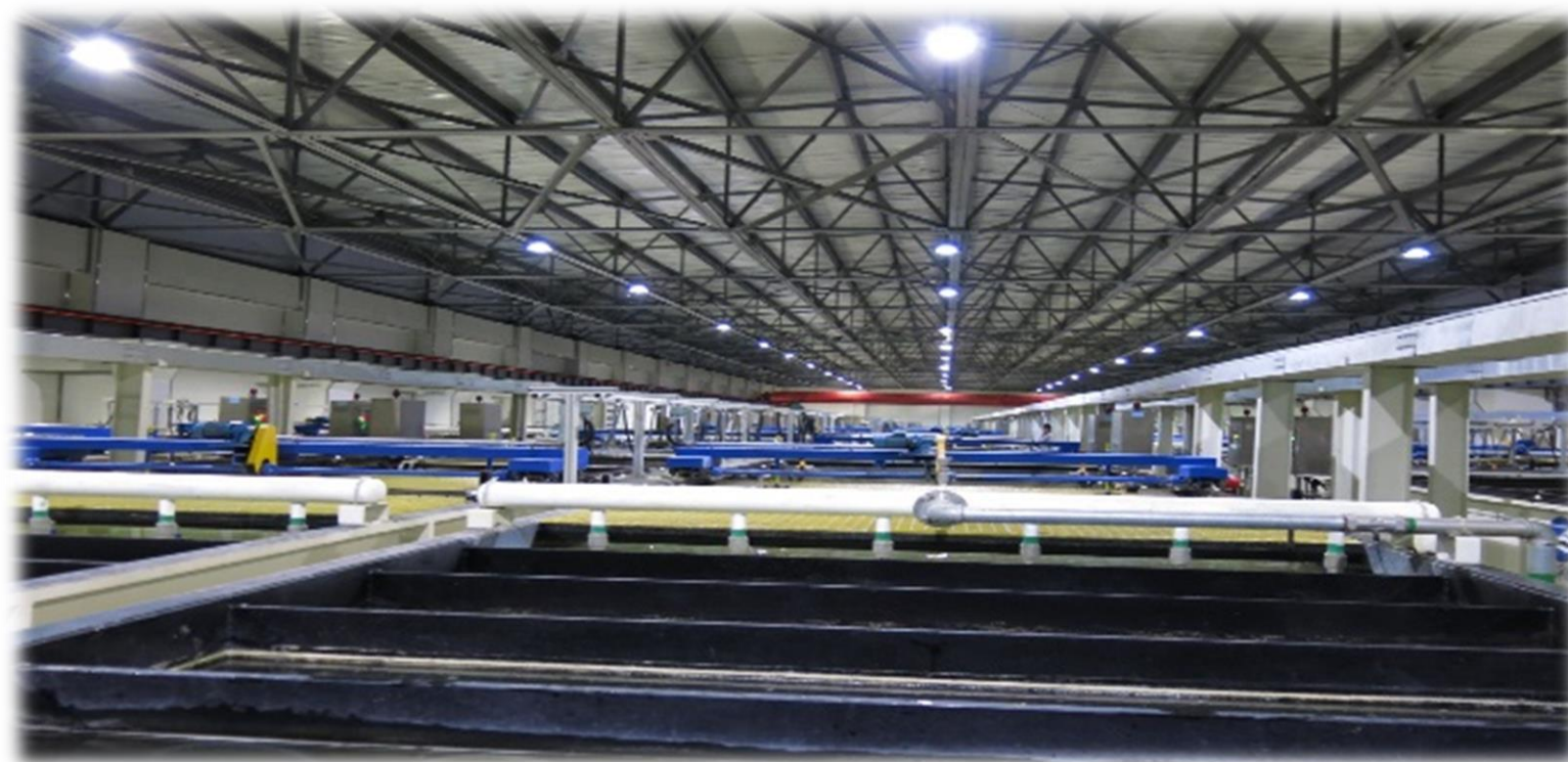
▲ 污水處理廠內的各項先進設備使團員大開眼界
