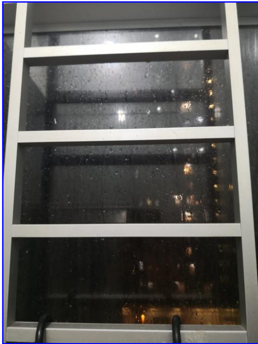
(圖 B): 滿東邨外牆管道滲漏問題
