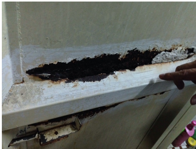
居民的廁所鐵門已嚴重腐蝕
