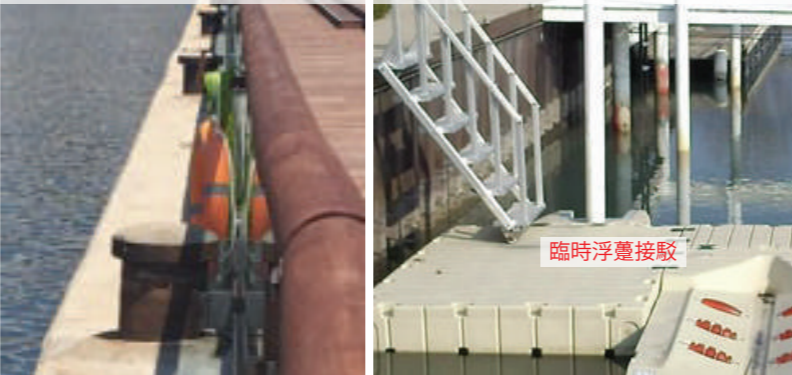
2 可考慮修改繫船柱旁的玻璃欄杆
