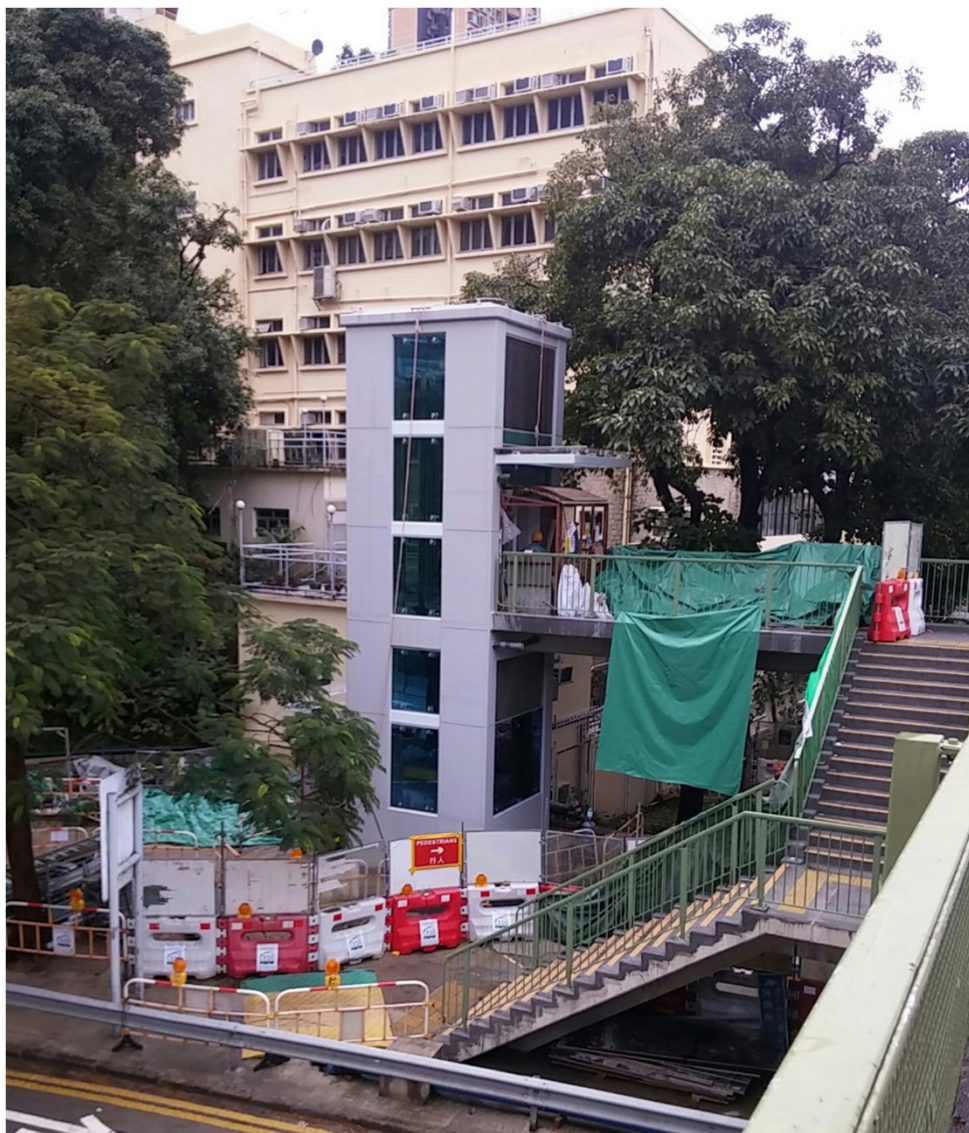
2號升降機照片
