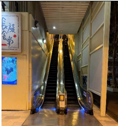
圖 4 位於長發商場前的扶手電梯，可上落平台
