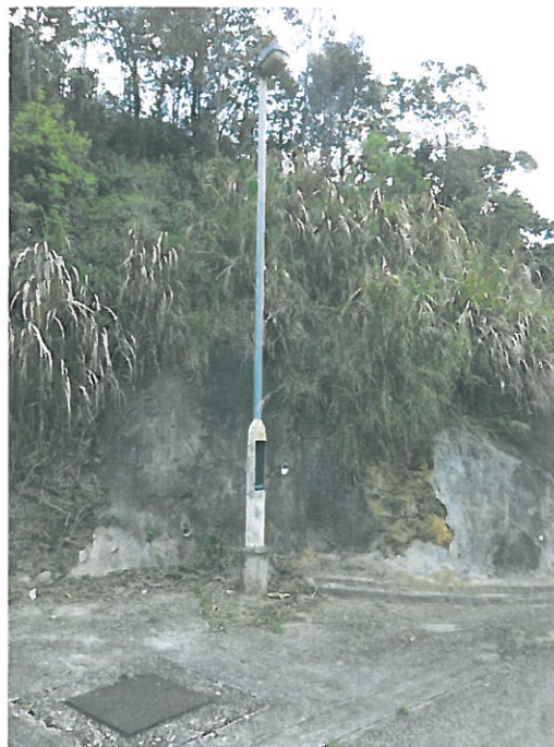
附圖二: 燈柱損壞
