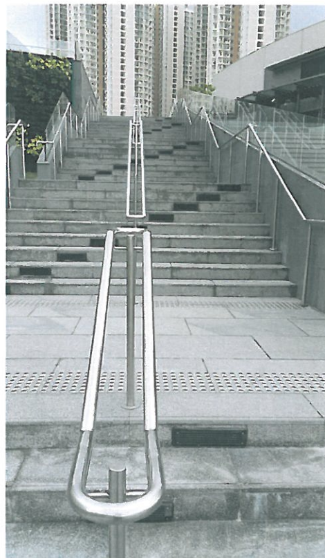
附圖二：樓梯的扶手欄杆視障設施不足
