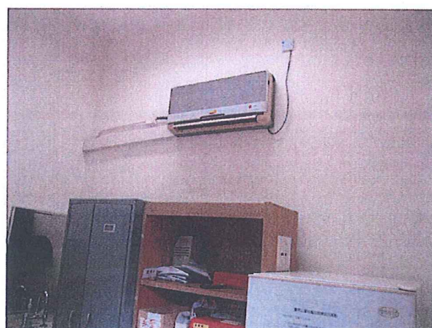
寶翠公園救護室內空氣調節現狀
