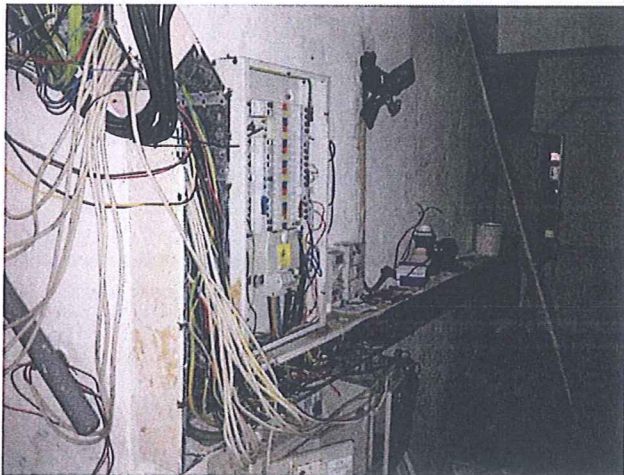
泵房內電力系統損壞
