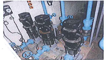
一期機房臭氧加壓泵位置
