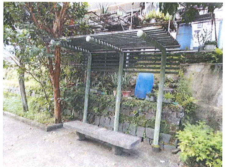
現時遊樂場座椅及簷篷狀況
