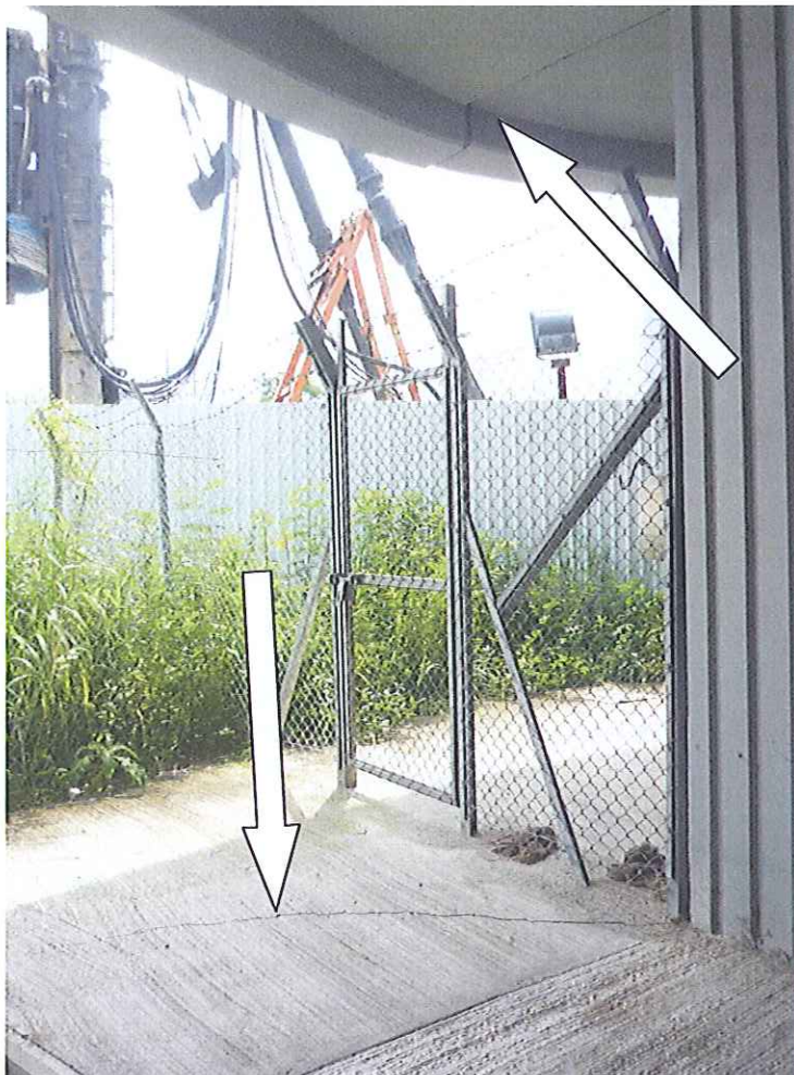
右邊橋底左右偏移及地面 出現裂痕
