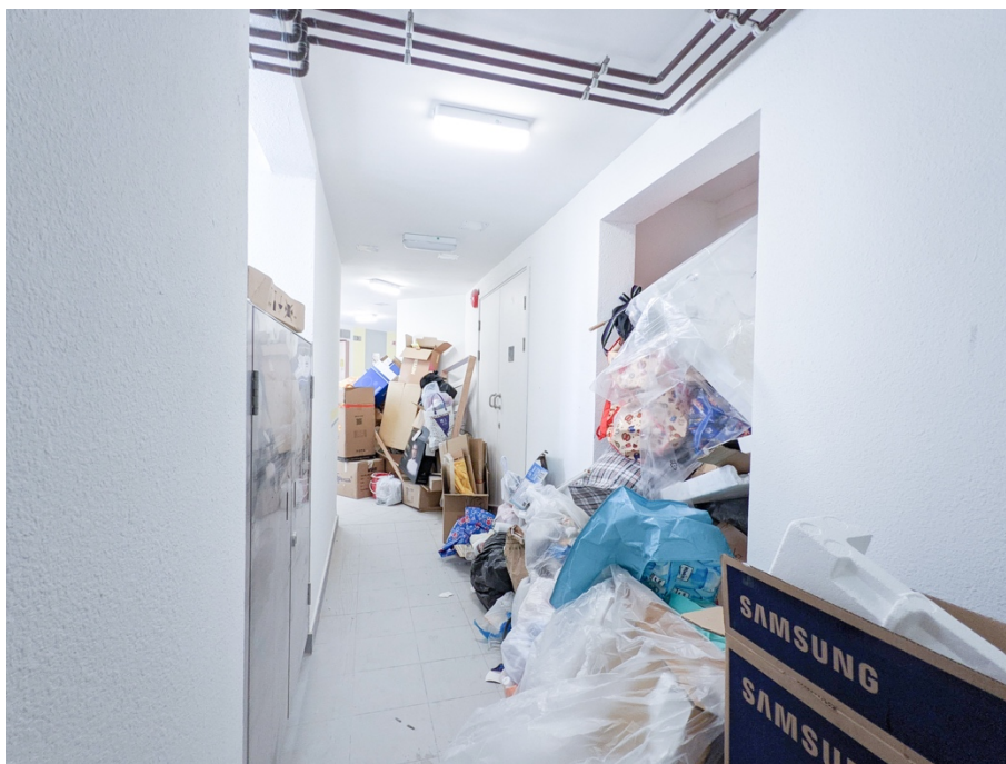
上述照片分別於 2021 年 1 月及 2 月拍攝，顯示雍明苑不同樓層的垃圾房堆積滿不同雜物，有業戶反映一星期內未見有人處理堆積的廢物，情況嚴重及造成火警隱患
