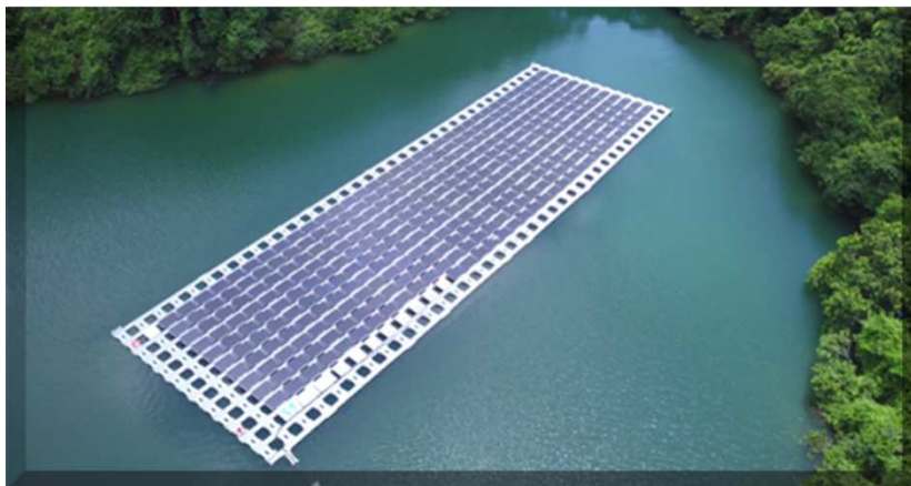
浮動太陽能板發電系統
