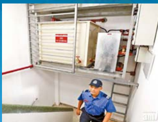
安裝於天台樓梯內部
