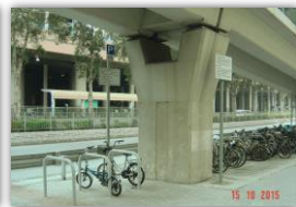
加設單車泊位 (海榮路)
