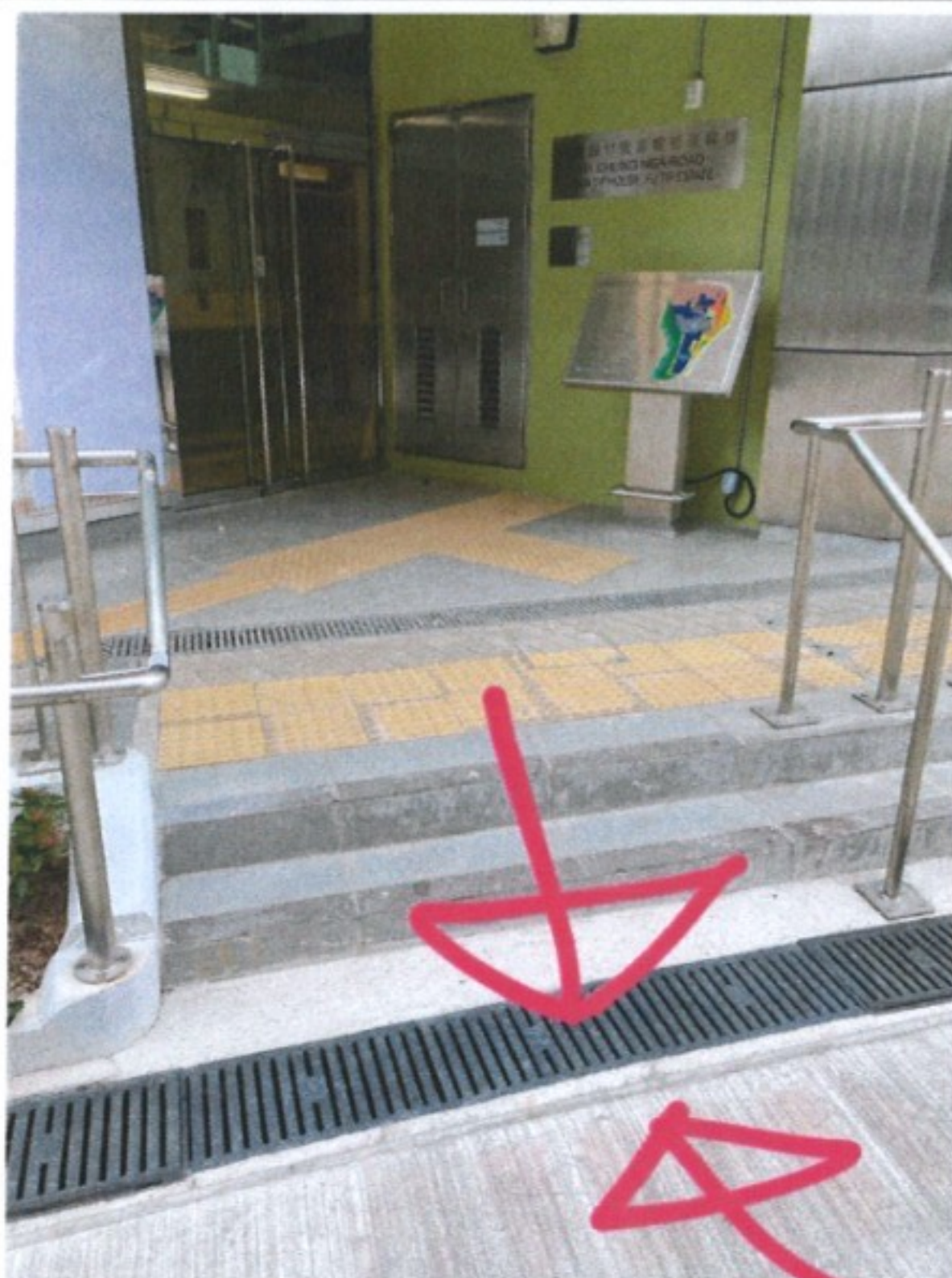
樓梯底下凸起之路面
