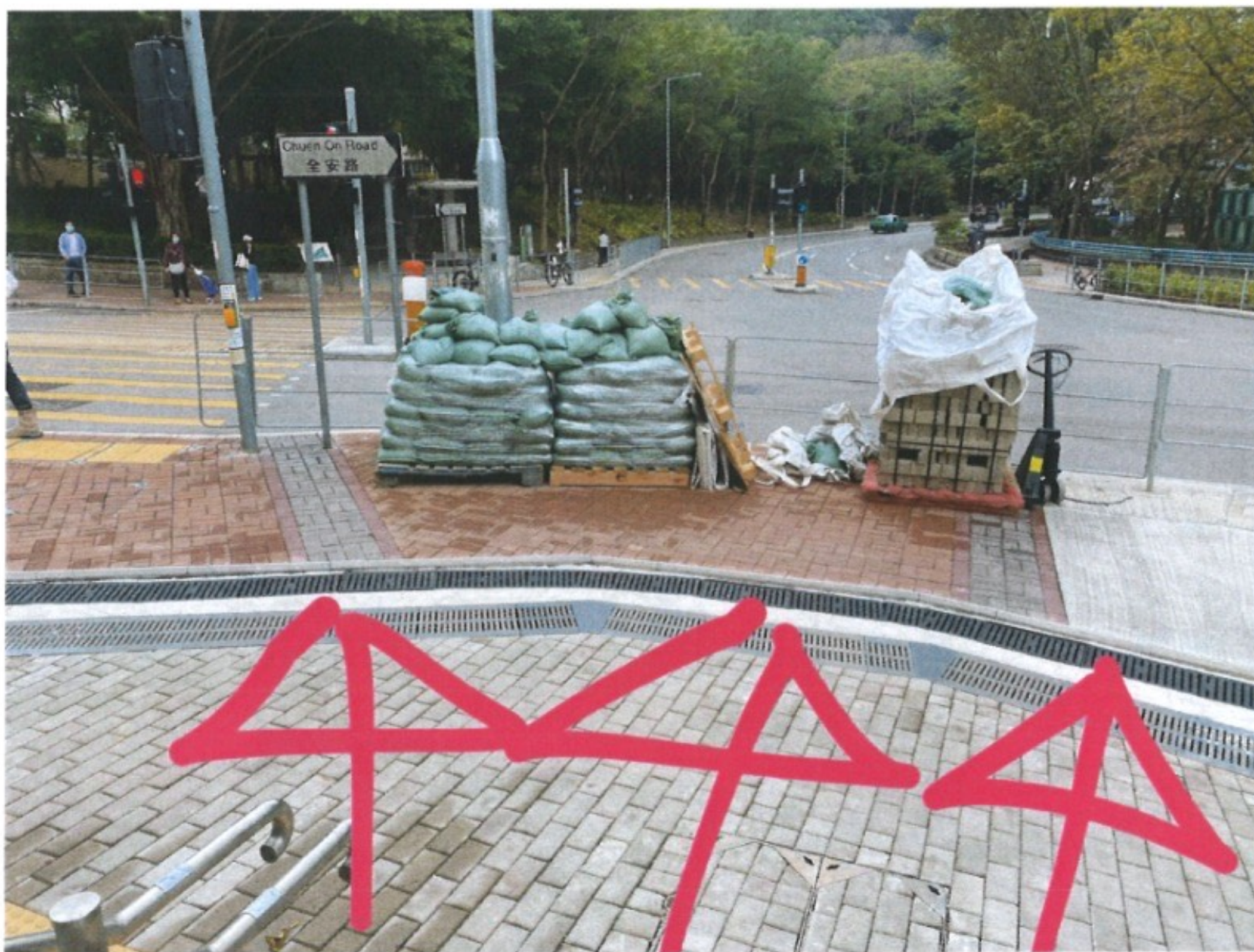
行人路中央連接處樓梯底下凸起之路面 2
