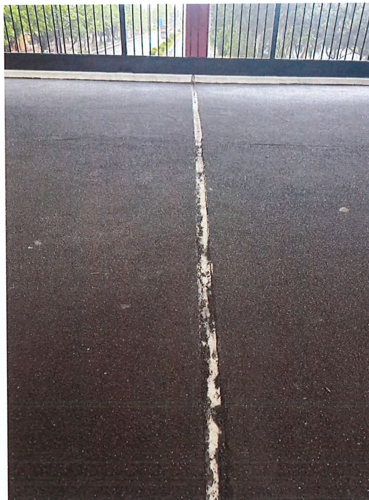
附圖：一田橋路面不平出現坑洞情況
