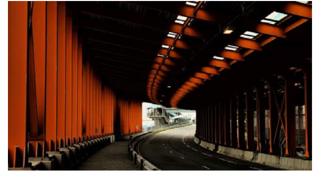
海安路隔音屏障
