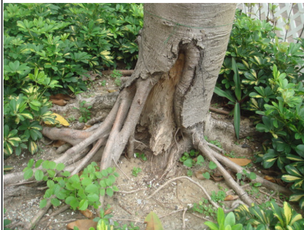
(樹洞腐爛，出現結構問題)
