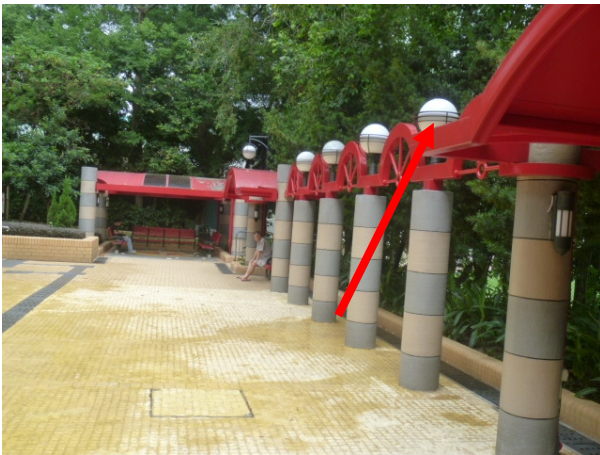
場內照明裝置
