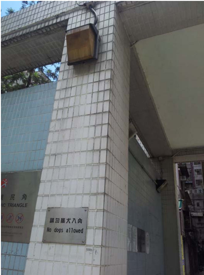
附圖 1：現有照明設施呈現老化跡象
