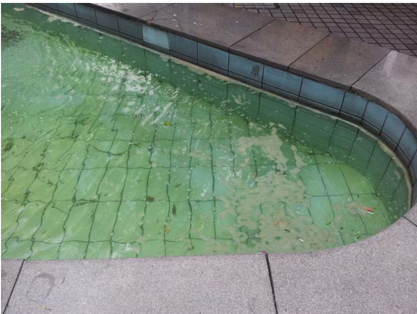
附圖 4：噴水池池水浮現異物且發出異味，衍生衛生問題
